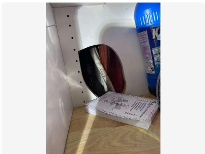
Køkkenfaldstamme skjult i rørkasse
